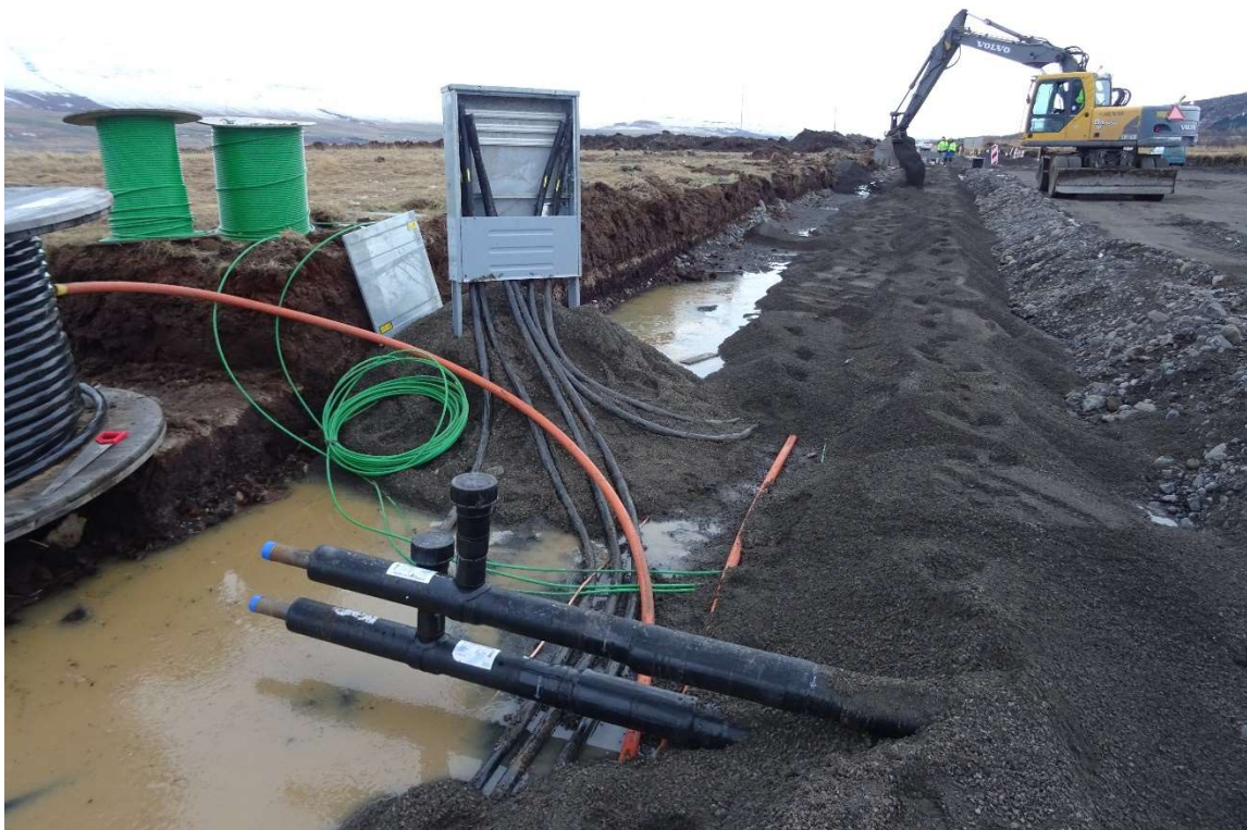
Mynd 5. Við Kjarnagötu 62. Rafmagnsskápur nr. 7
