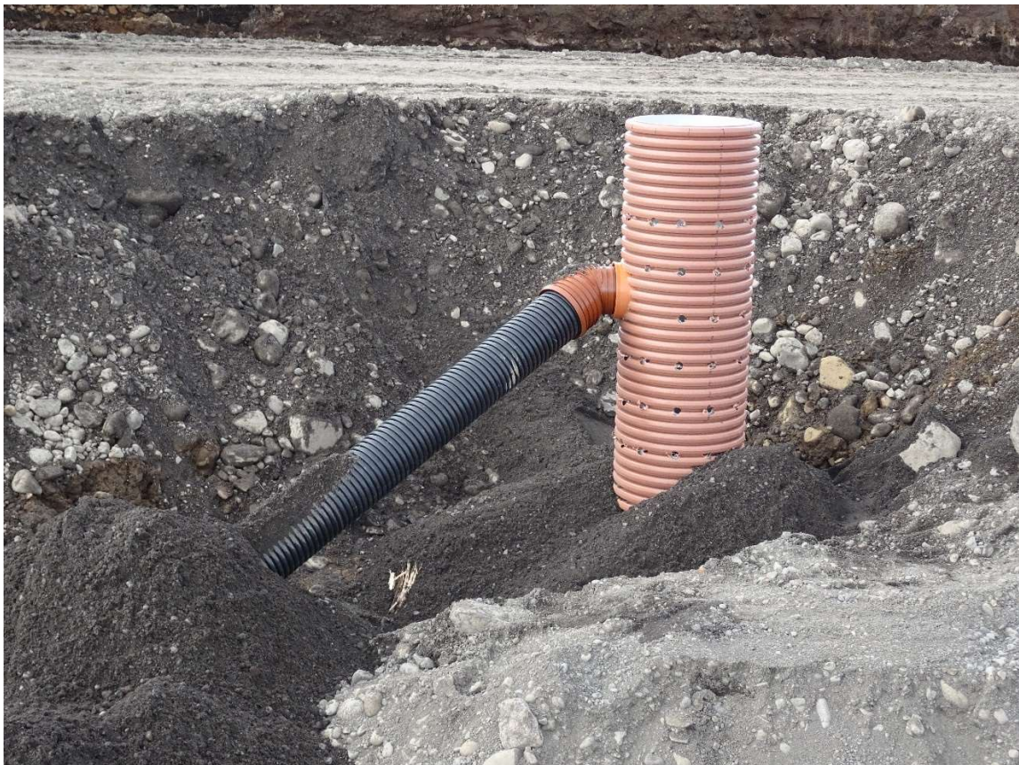
Mynd 4. Kjarnagata regnvatnsbrunnur
